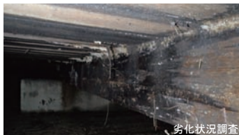
劣化状況調査
