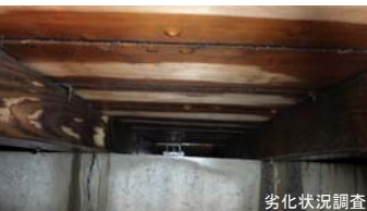
劣化状況調査
